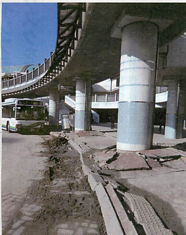
ディズニーランドで有名なJR舞浜駅前。舗装が割れ、噴出した泥水が乾いて、車道には大きな砂山ができた（3月13日撮影）
